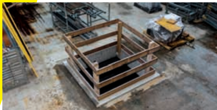
9 Apertura protetta con parapetti.
