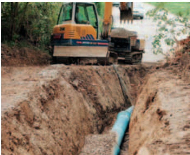
9 Ab 1,5 m Tiefe immer Böschung/Spriessung.
