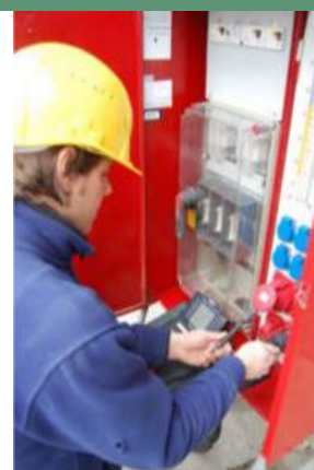
Quadro elettrico di cantiere
