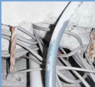
Sbarramenti antincendio con cuscini di amianto
