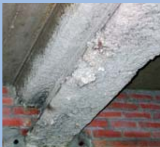
Isolamento in amianto spruzzato
