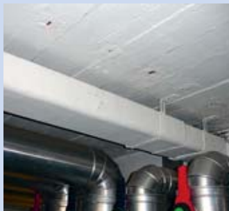
Canaletta per cavi in fibrocemento
