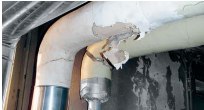
Tubo con malta contenente amianto
