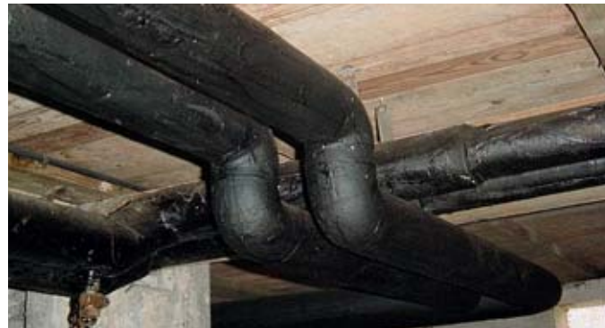
Tubo con guaina bituminosa contenente amianto
