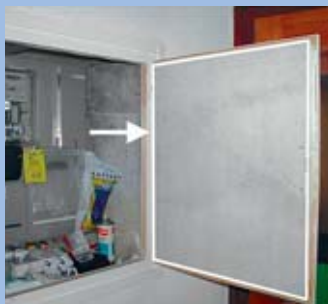
Pannello antincendio contenente amianto
