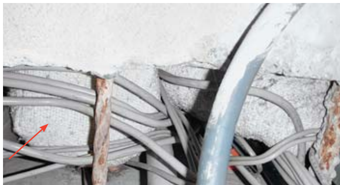
Cuscini di amianto
