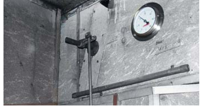
Canale di ventilazione in pannelli di fibrocemento
