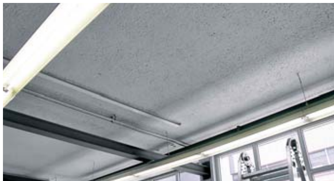
Rivestimento in amianto spruzzato
